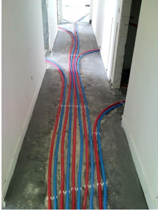
Şekil 4.23. Şap altı ısıtma gidiş-dönüş boruları dağılımı Bizimevler-2 Şantiyesi
